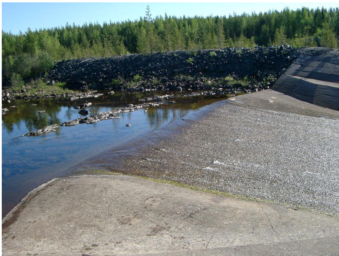
Figur 5: Den utpekade betongklacken som blockerar utloppet från den gamla älvfåran ut i Treholmarna/ övre vargforsdammen (Norsjö Sportfiskeklubb).
